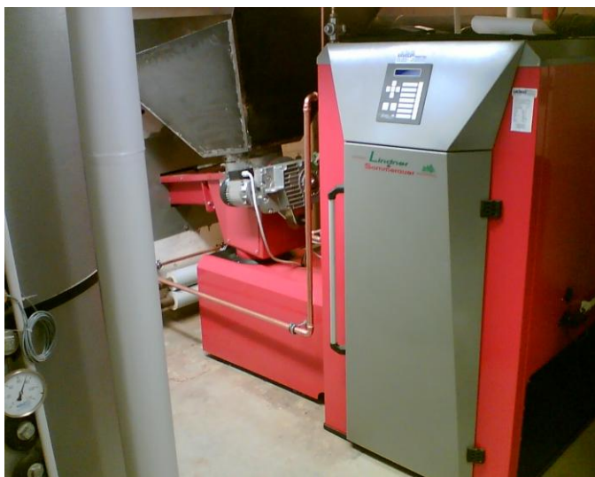
Bild 3 Technische Zentrale Wohngruppe Möhnesee nach der Sanierung
