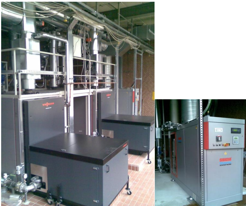
Bild 3: Technische Zentrale LWL-Klinik Marl-Sinsen nach erster Sanierung Links Kesselanlagen Rechts BHKW
