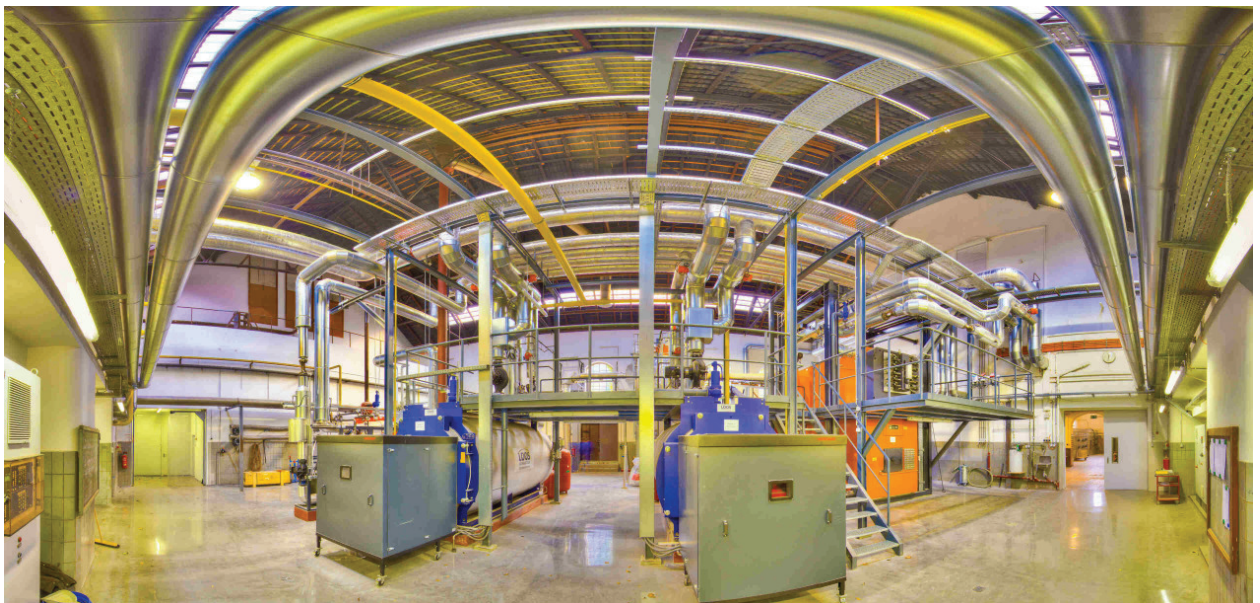
Bild 14: Technische Zentrale LWL-Klinik Warstein –Gesamtübersicht-
